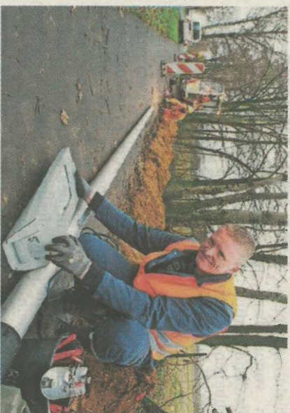
Lars Steffen montiert den Lampenkopf auf einen Mast. Lampe für Lampe arbeitet er sich gen Buxtehude vor.
